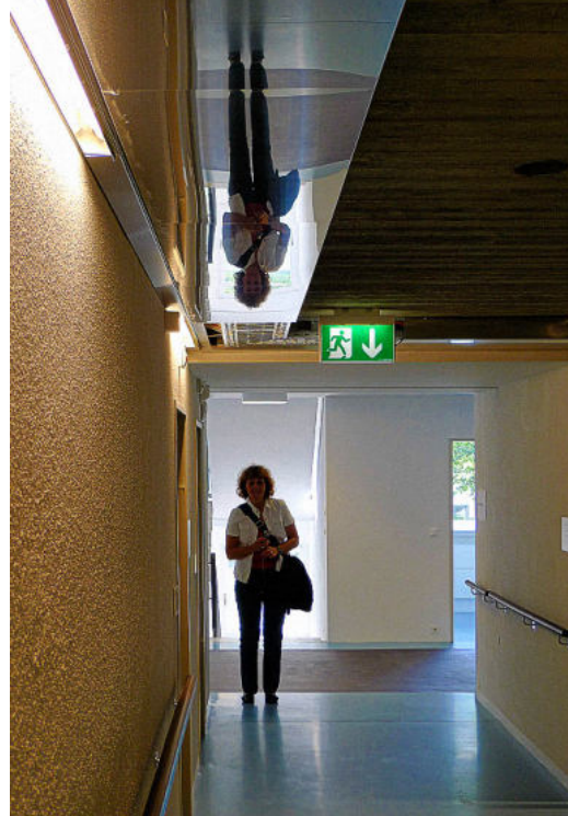
Reflektierender Lüftungskanal im Flur einer Pflegeeinrichtung.
