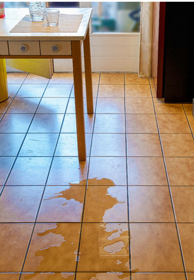
Wasserpfütze auf dem Küchenboden.
